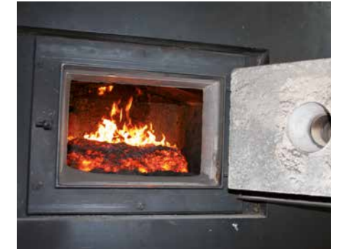
Sulzbach an der Murr Schulzentrum und Wohngebiet Kessel: Holzhackschnittel, Heizöl
