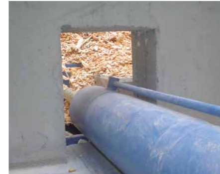
Kleinostheim Schwimmbad Kessel: Holzhackschnittel, Erdgas
