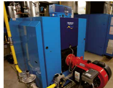
Diez Schwimmbad Kraft-Wärme-Kopplungsanlage (Erdgas)
