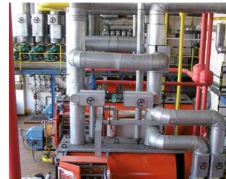
Welzheim Industrie Kessel: Holzpellets
