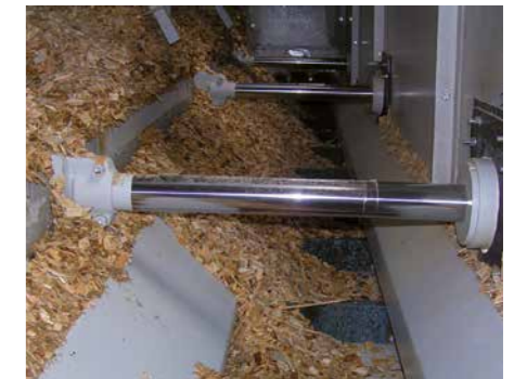
Oberstenfeld Industrie Kessel: Holzhackschnittel, Erdgas, Heizöl
