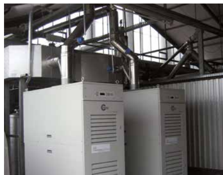
Erdmannhausen Deponie „Am Lemberg“ Mikrogasturbine (Deponiegas)
