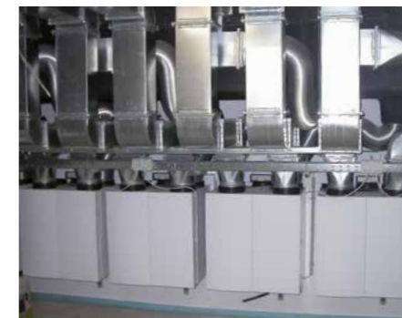
Wiesbaden Verwaltungsgebäude Wärmepumpe (Strom)
