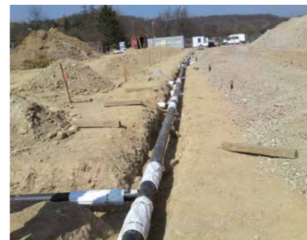
Kelkheim Wohngebiet „An der Roten Mühle“ Kraft-Wärme-Kopplungsanlage (Erdgas)
