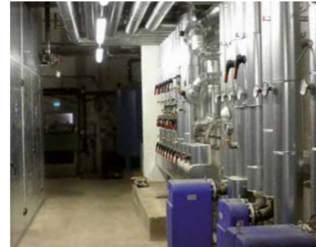
Lorch Schlaadt Plastics GmbH Kraft-Wärme-Kopplungsanlage (Erdgas)
