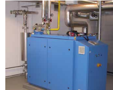
Limburg Generationenzentrum Kraft-Wärme-Kopplungsanlage und Wärmepumpe (Erdgas + Strom)
