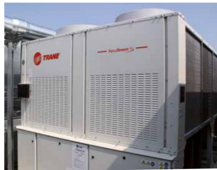
Bad Soden am Taunus Messer Group Kälteanlage
