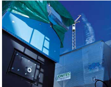
Bad Friedrichshall Holzheizwerk Kessel: Holzhackschnittel, Erdgas, Heizöl
