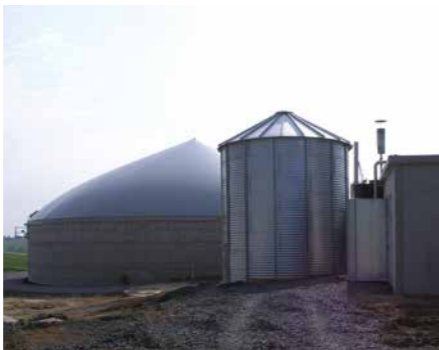
Bad Wimpfen Gesundheitszentrum, Verwaltung und Gärtnerei Kraft-Wärme-Kopplungsanlage (Biogas)
