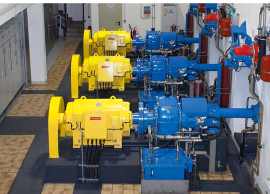
Wasserkraftwerk Altwied, Generatoren
