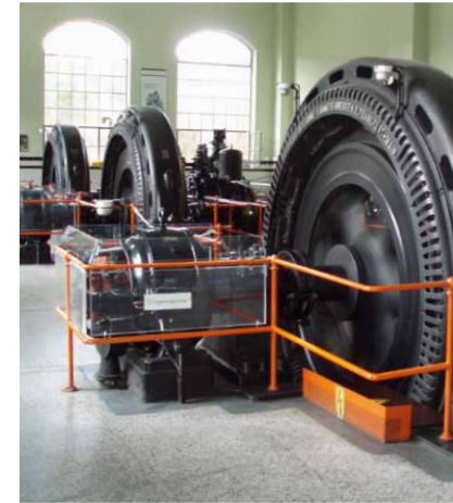
Maschinenhaus im Wasserkraftwerk Friedrichsseggen
