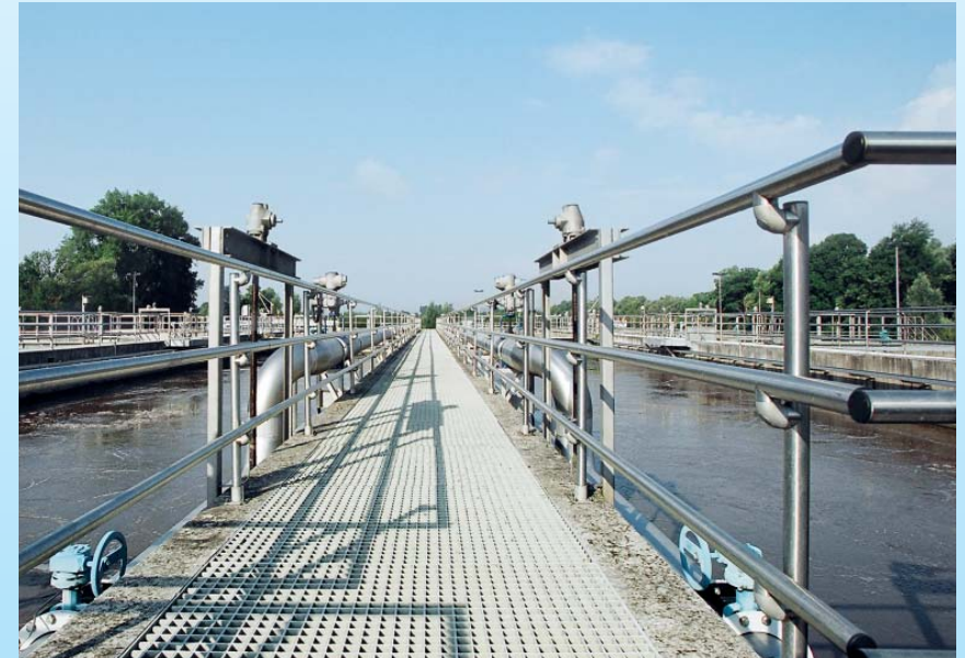
Biologische Stufe der Abwasserreinigung
