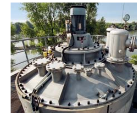
Faulturmrohrmischer zur Verbesserung der Gasausbeute
